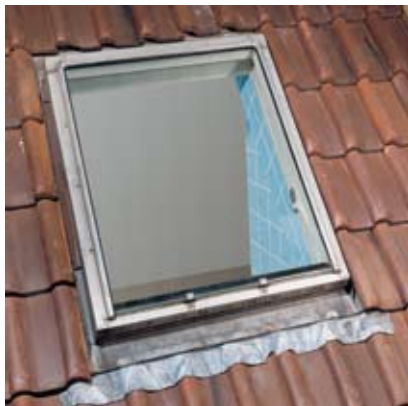
Stare okna dachowe bardzo często wymagają wymiany
